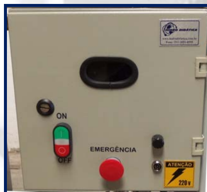
Figura 23. Painel de comando.
