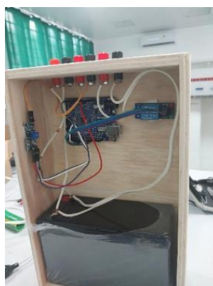
Figura 4: Caixa de controle e alimentação do sistema.
